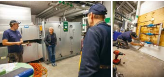
Arbetet i föreningens undercentral påbörjades direkt efter att vattnet sugits bort. Byggfläktar fick stå på i över två månader för att torka ytorna. Andreas Eklund och Kurt Eklund, från Eklunds Allt i ett, renoverar undercentralen i Brf Tryckaren.
