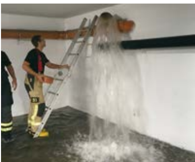
Några veckor efter skyfallet i juli blev det åter igen översvämning i garaget. Det kraftiga regnet gjorde att vatten forsade in genom en inspektionsslucka till en dagvattenledning.
